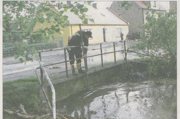
ZAPCHANY PRZEPUST NA LIPINCIE PRZY UL. WODNEJ był przyczyną podtopienia kamienicy po ulewie sprzed dwóch tygodni
