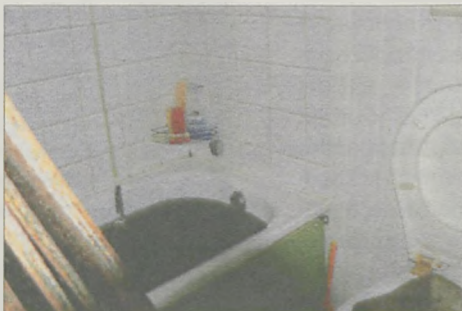
POMIESZCZENIA ZALEWAŁY ŚCIEKI z kanalizacji sanitarnej
