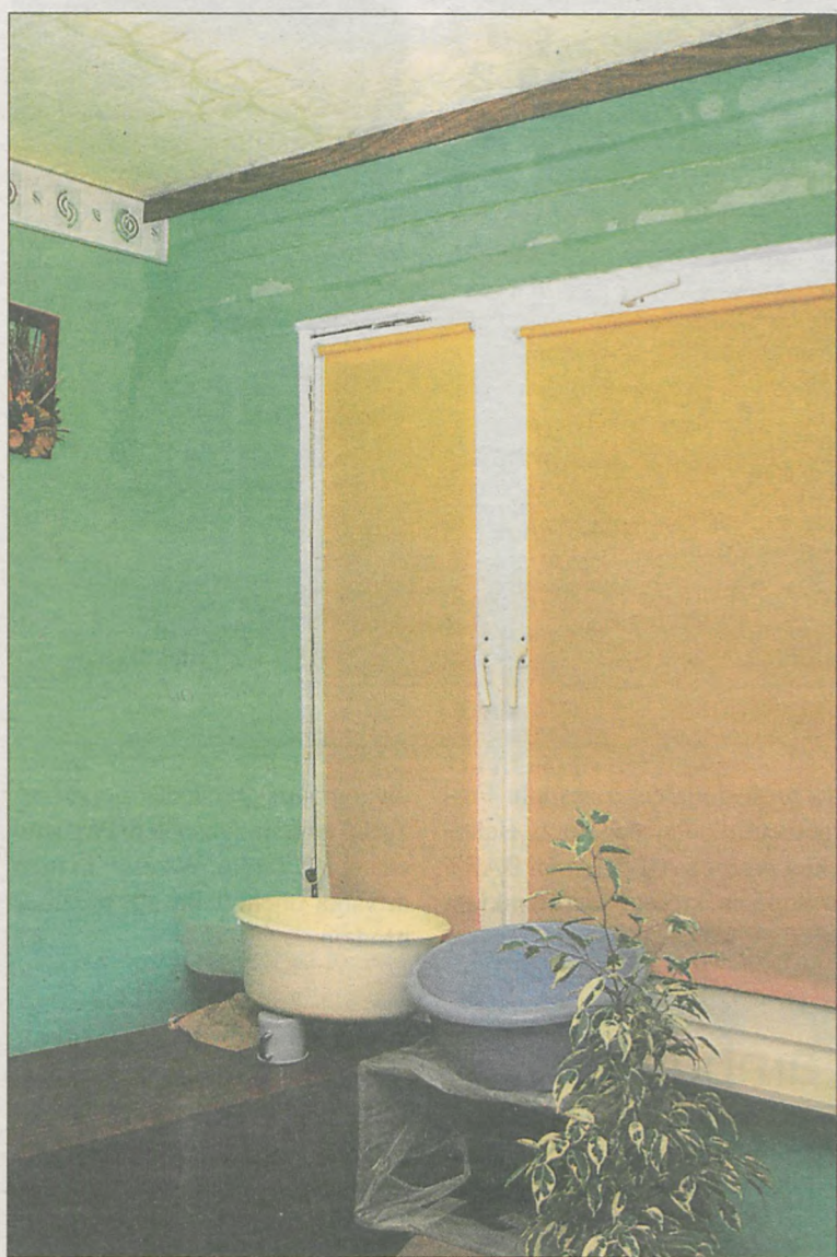
PADAJĄCY W PIĄTKOWY WIECZÓR DESZCZ spowodował, że dach na bloku nr 2, uszkodzonym kilka godzin wcześniej podczas wichury, zaczął przeciekać.
