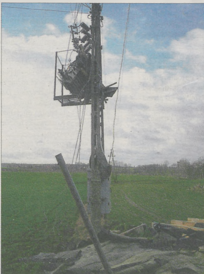
W SIEDLEMINIE PŁATY ZERWANEGO DACHU z budynku gospodarczego uszkodziły stację transformatorową
