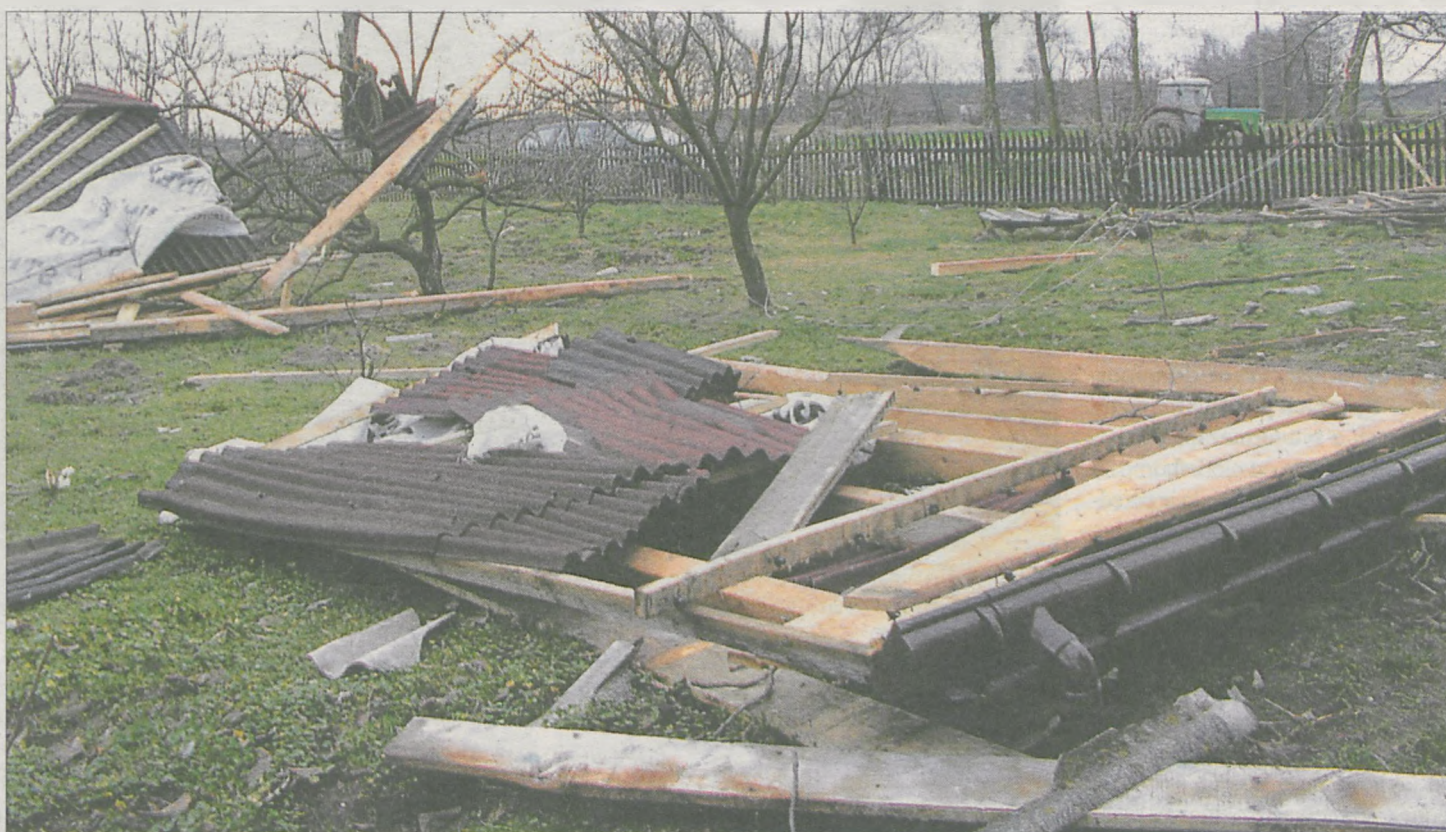
NAJWIĘKSZE SZKODY huragan wyrządził w Lubini Małej. W jednym z gospodarstw zniszczył trzy budynki i stojący na podwórzu samochód
