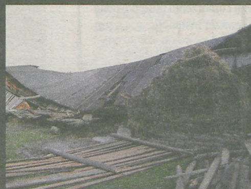
W Cerekwicy Nowej huragan powalił drewnianą stodołę
