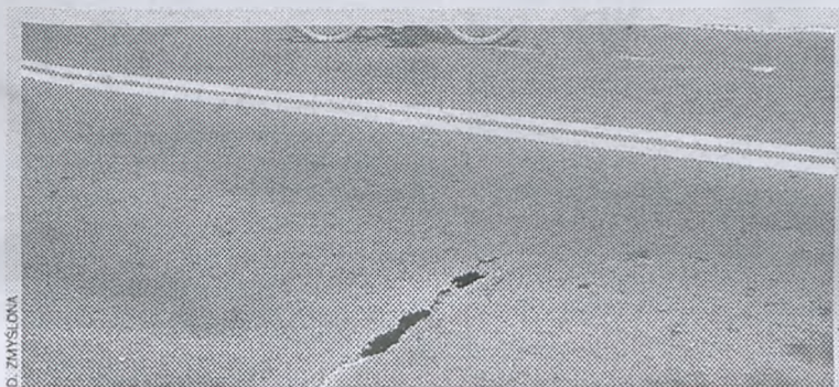
Dziura na Sienkiewicza w Krotoszynie. Takie pęknięcie w jezdni ul. Sienkiewicza pojawiło się w poniedziałkowe przedpołudnie. Dziura znajduje się dokładnie na wprost sklepu Eko i bardzo utrudnia jazdę.
