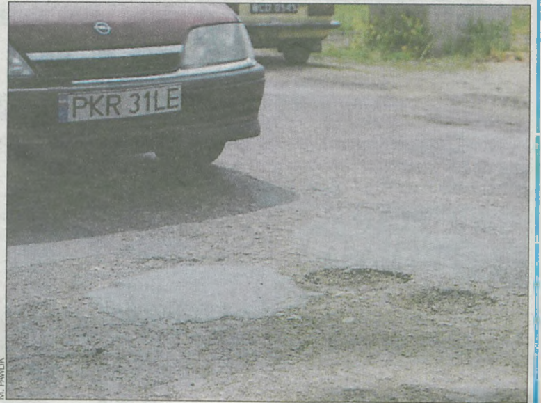
Tak wygląda niedawno wyremontowana jezdnia
