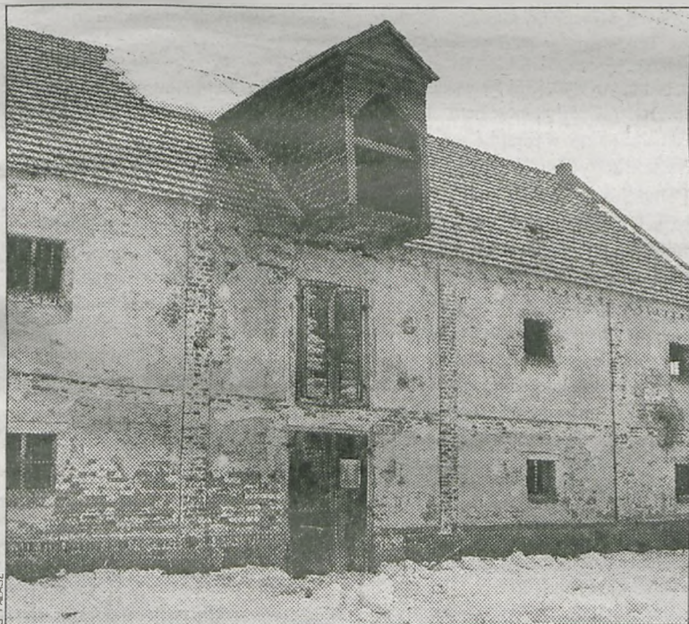
Ten zdewastowany magazyn wciąż figuruje w rejestrze zabytków województwa dolnośląskiego
