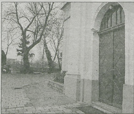
Nad tym wejściem brakowało daszka
