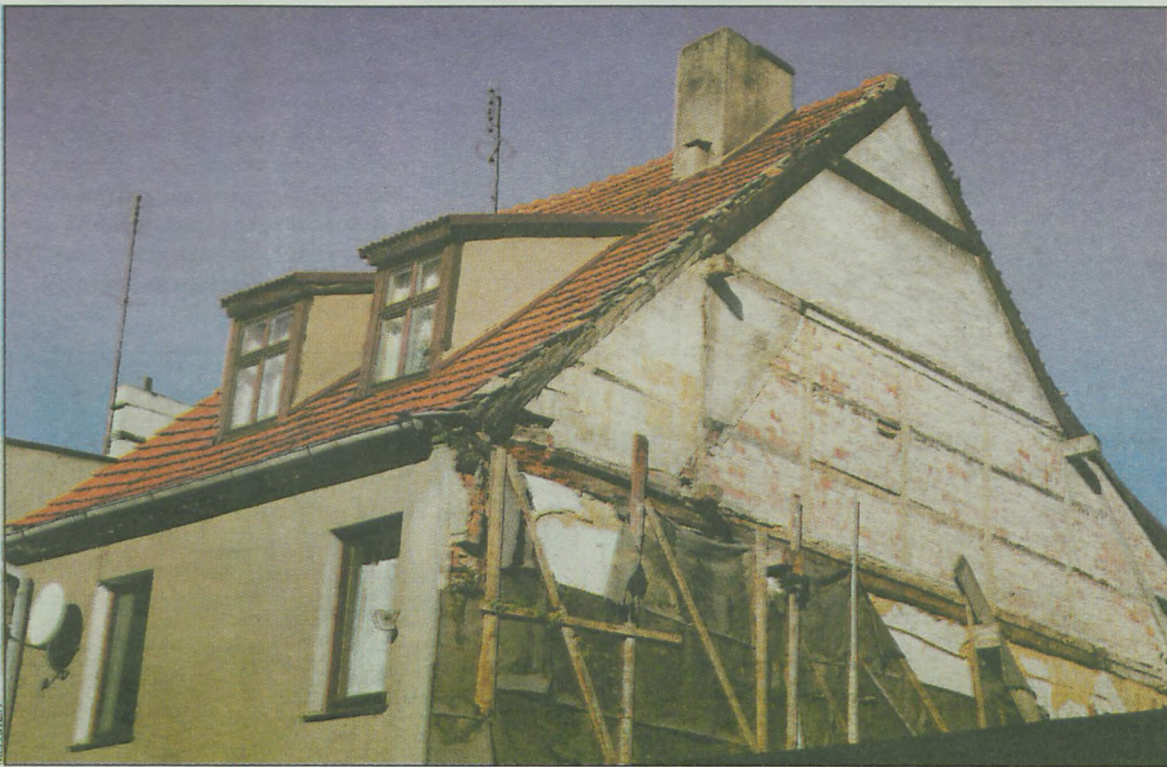
Ściana nośna została zniszczona
