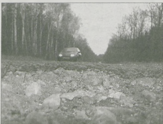
- TO NIE JEST NAWIERZCHNIA BITUMICZNA i dlatego tak to wygląda po zimie, jak wygląda - mówi Jerzy Helwig, dyrektor Zarządu Dróg Powiatowych w Środzie Wlkp.
