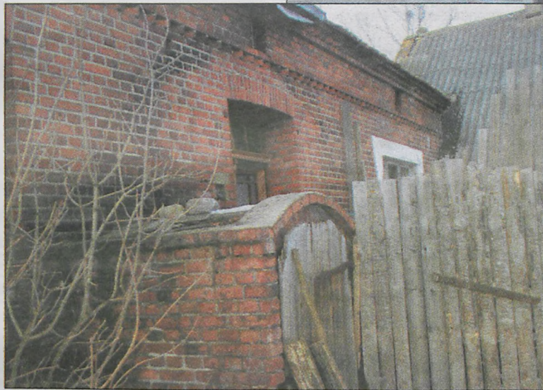
Dom jest w opłakanym stanie
