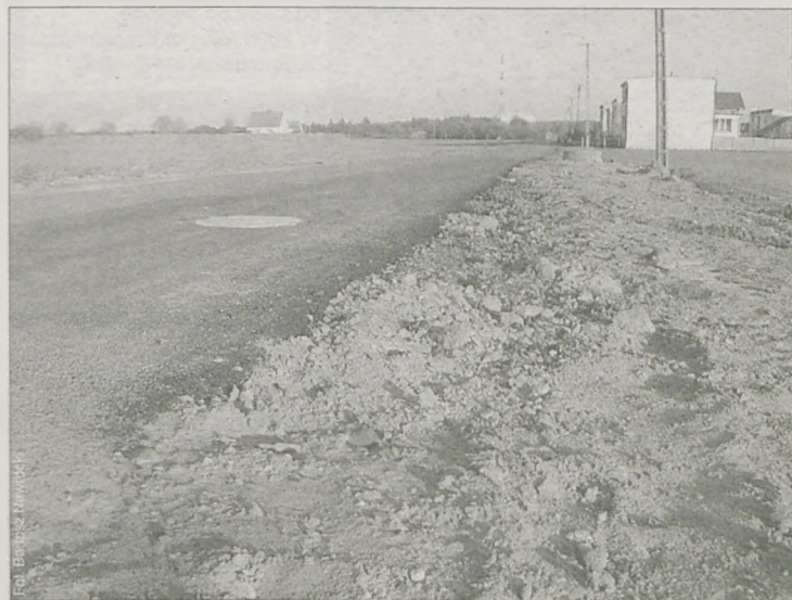
RADNY STEFAN GRZELAK uważa, że pracami kanalizacyjnymi zniszczono nawierzchnię ul. Polnej w Górze
