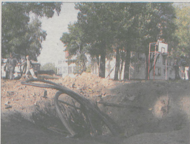
PRACOWNICY EKO-DBAJ zostawiając wyrwę z wystającymi na zewnątrz przewodami narazili na niebezpieczeństwo bawiące się dzieci
