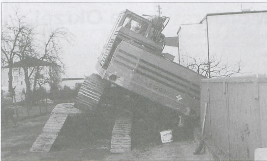
Koparka BUDMASZ-u niebezpiecznie przechyliła się na posesję przy ul. Granicznej
