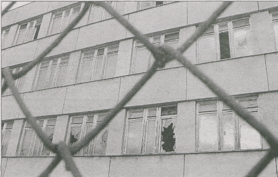
Ten niszczący budynek należy do prywatnej uczelni z Leszna
