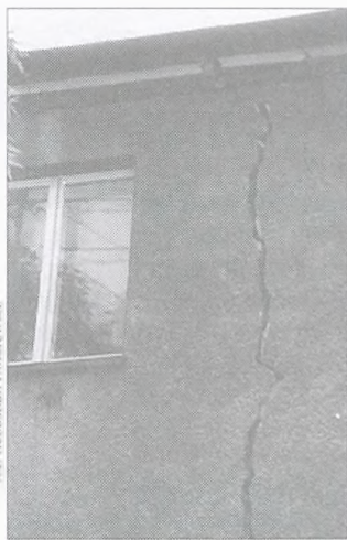
Pęknięcie ma kilka centymetrów szerokości
