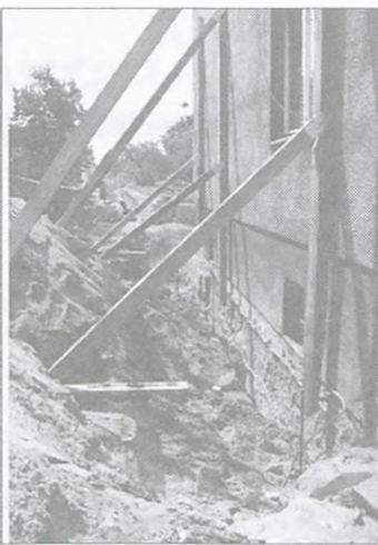
Walącą się lewą stronę budynku podparły trzy stemple
