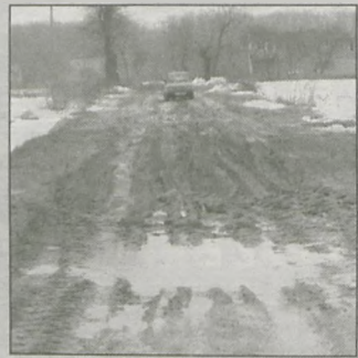
W ROSZKOWIE z poruszaniem się po błotnistej nawierzchni miały problem samochody
