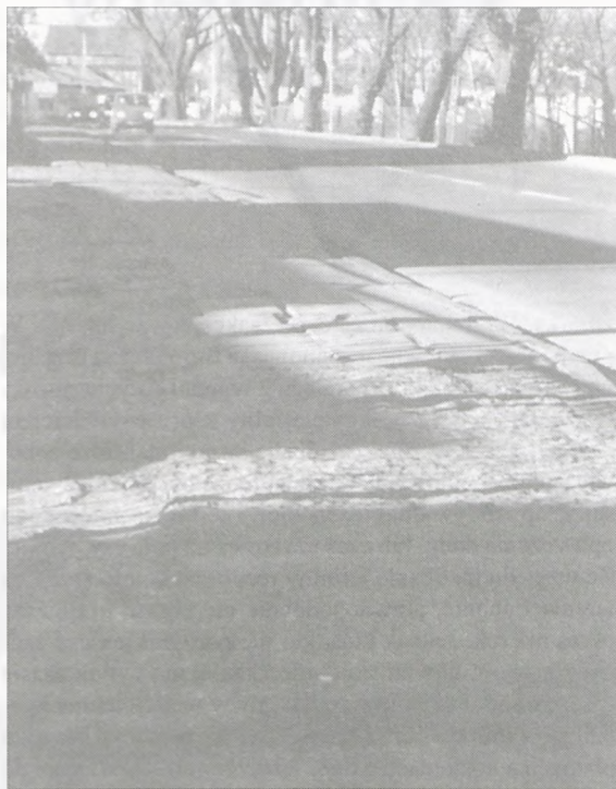
Chodnik przy ul. Powstańców Wlkp. naprzeciw „Pol-Agri” - jeden z wielu w Luboniu w tym stanie. Budowę chodników i dróg Zarząd Miasta uznał w założeniach do budżetu na r. 1998 za priorytetowe.
