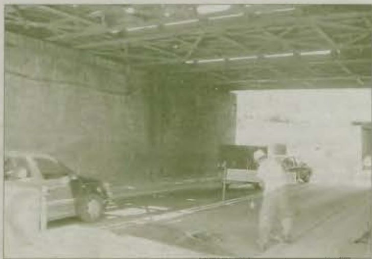
PODZAS REMONTU na jezdni runęła część mostownicy
