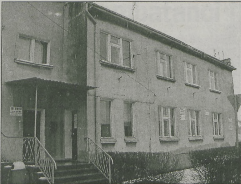
Przychodnia wymaga gruntownego remontu
