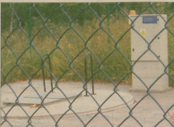
PONAD 20 PRZEPOMPOWNI ścieków będzie funkcjonowało w gminie Jarocin po zakończeniu budowy kanalizacji. W tej chwili działa już 9. Jedną z nich znajduje się w Cielczy
