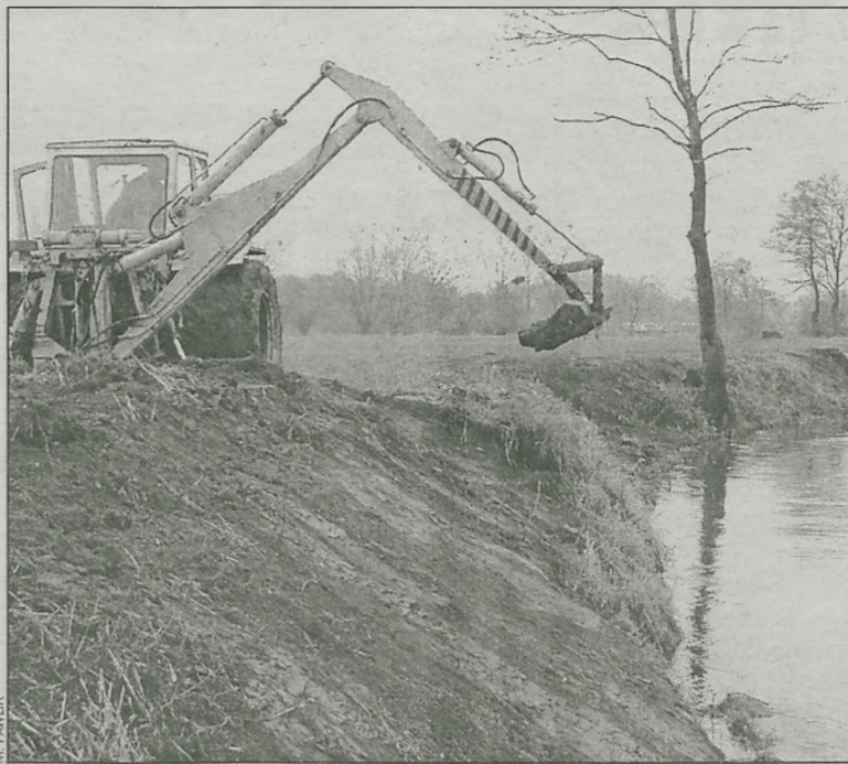
Jesienią ubiegłego roku częściowo ścięto skarpy nad Orlą
