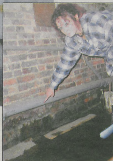
Woda w piwnicy Wandy Drejkarz przesącza się przez mur na wysokości kilkunastu centymetrów
