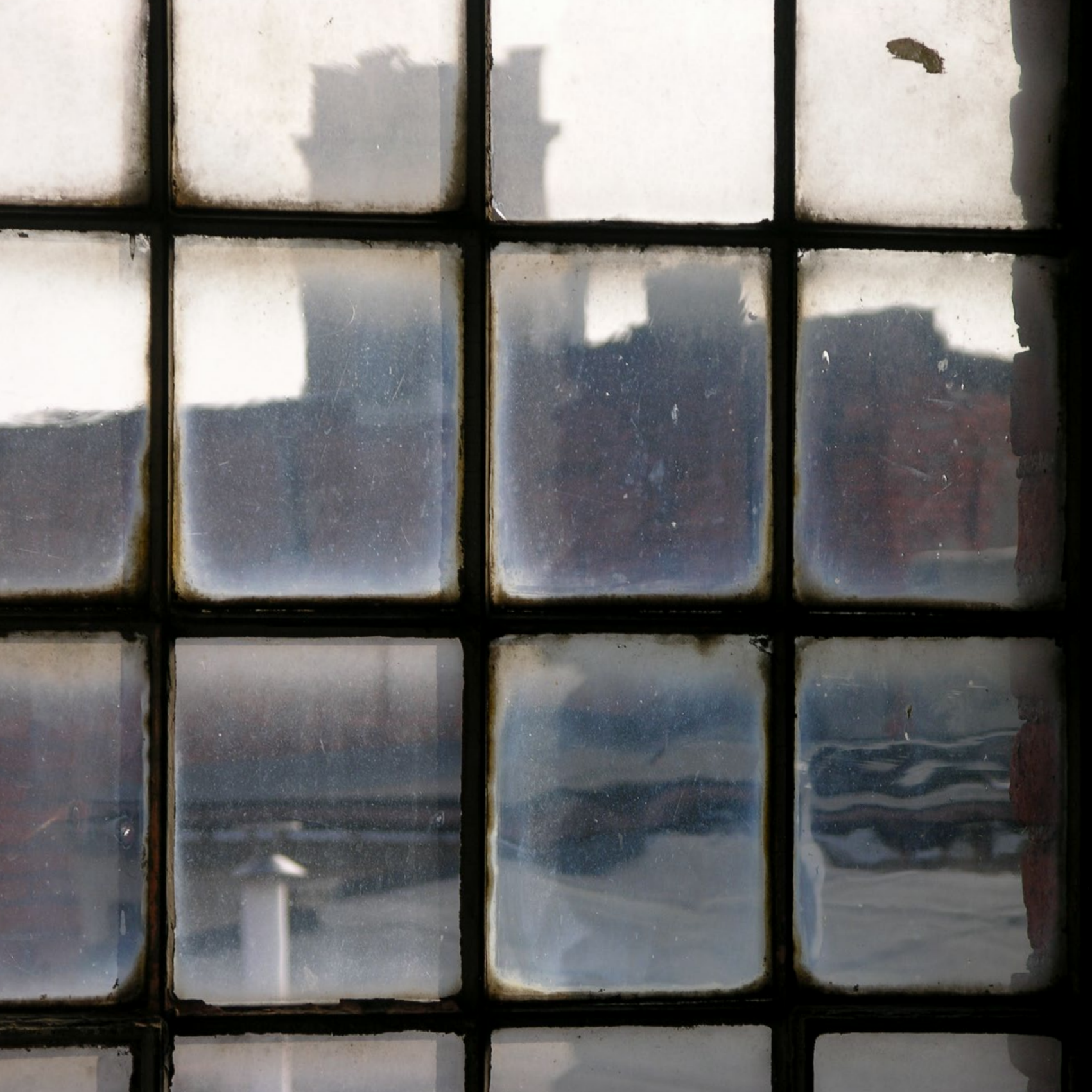
Widok z okna Galerii 33 w Ostrowie Wielkopolskim (wieża strażacka) View from the Gallery 33 window in Ostrów Wielkopolski (Fire Department Tower)
