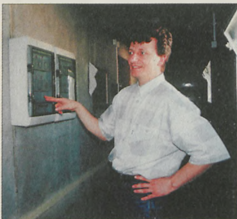
Janusz Wojtczak pokazuje sterowniki, które regulują poziom temperatury, wilgotności i wentylacji
