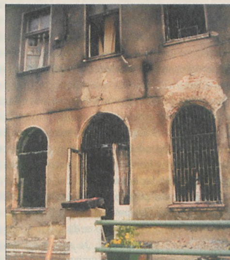
Gdyby ogień dostrzeżono później, spłonąłby cały budynek
