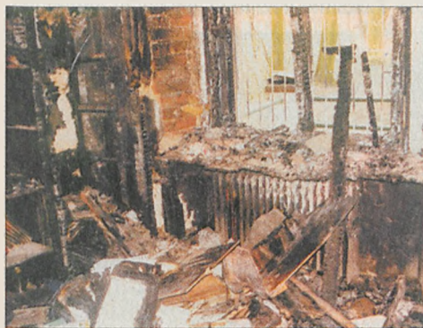
Pożar zniszczył cenne meble i dokumenty
