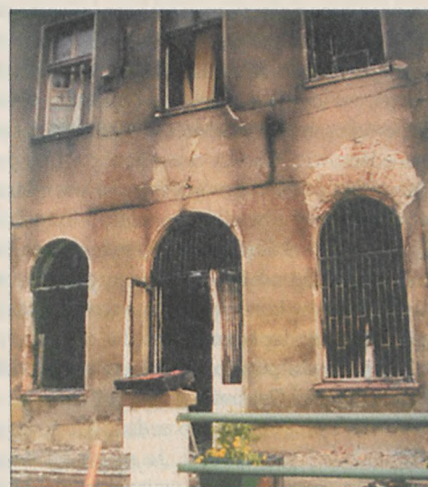
Gdyby ogień dostrzeżono później, spłonąłby cały budynek
