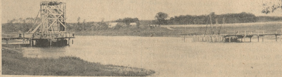
Obecny stan robót przy budowie mostu przez Wartę pod Rogalinkiem. Prace te rozpoczęto już w roku 1935.
