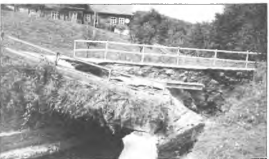
Zniszczona droga dojazdowa do wsi
