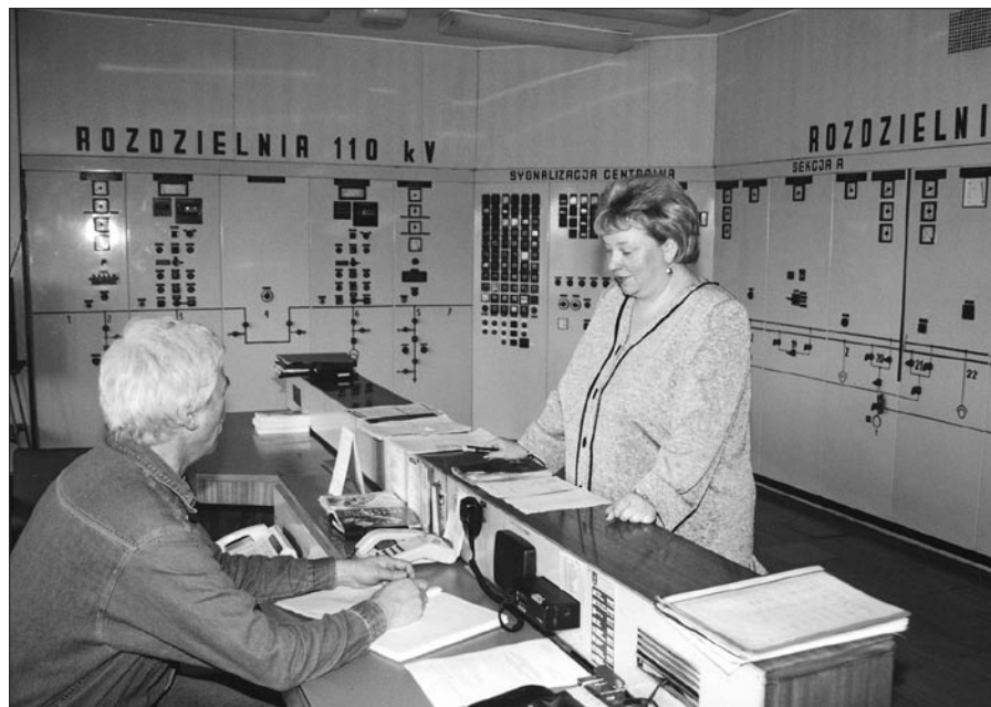
Główna rozdzielnia energii elektrycznej w spółce „Elport”.
