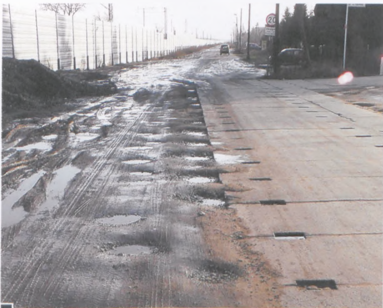
Ul. Dworcowa od strony skrzyżowania z Grzybową i Ogrodową (okolice przejścia przez tory kolejowe na wysokości Luveny). Z prawej betonowy dukt z płyt dla pojazdów, z lewej pobocze dla pieszych i rowerów? Płyty kończą się na wysokości ul. Platanowej (przy znaku zakazującym jazdy powyżej 20 km/h). Dalej (w kierunku Podgórnej, Krętej) już tylko błoto fot. Hanna Siatka
